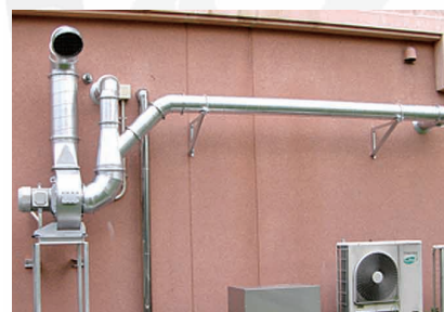
屋外から見た強制排気装置
